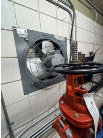
Figure 59: Wall Exhaust Fan
